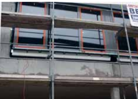
Die Sanierung von Fassaden öffentlicher Gebäude mit Wärmedämmung steht ganz oben auf der Prioritätenliste der Kommunen.
